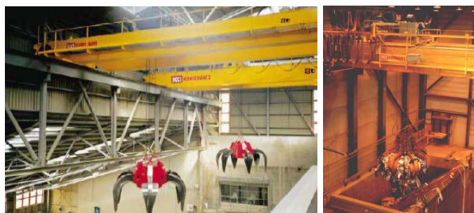
Slika 3. Kran sa grabilicom za zahvatanje otpada iz bunkera
