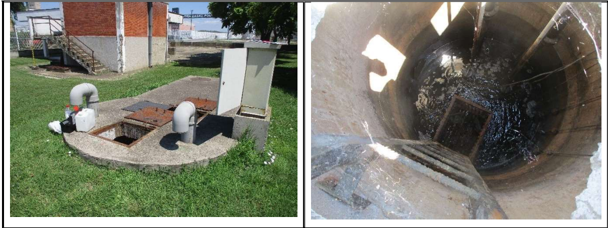
Sabirna jama pre ispuštanja u kanalizaciju
