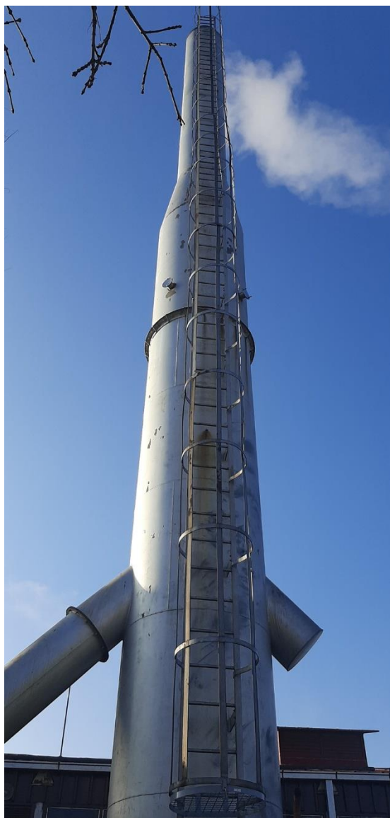
E1 - emiter kotlovskog postrojenja
