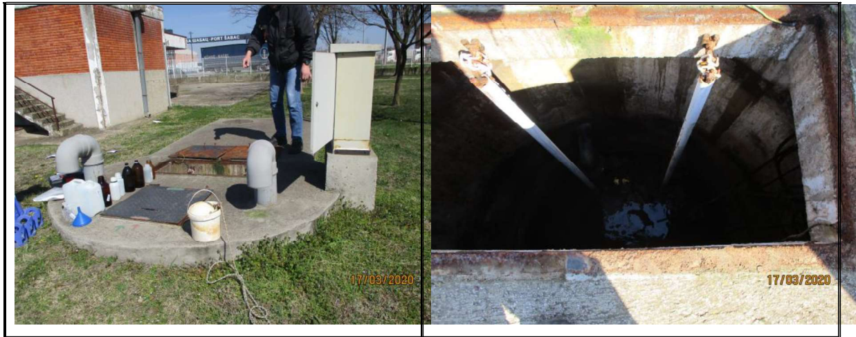
Sabirna jama pre ispuštanja u kanalizaciju
