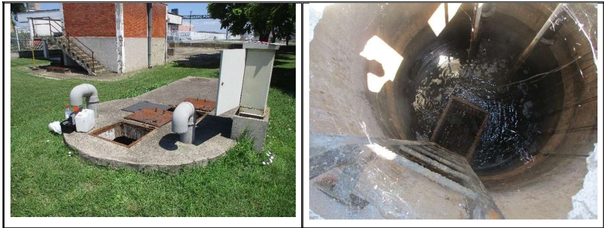
Sabirna jama pre ispuštanja u kanalizaciju
