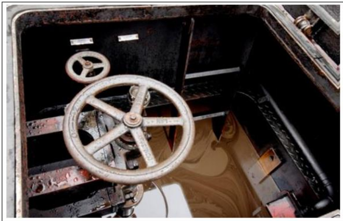
Слика бр.25: Каљужне воде у колибици пловила
